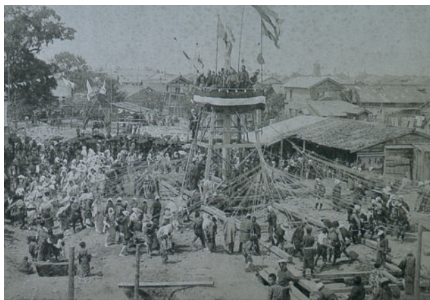
新善光寺建築の際のドンツキサワギ(明治35年)。昭和21年の大火災で新善光寺も全焼しているため、これは貴重な一枚。ドンツキサワギとはドンチャンサワギのことで、機械がなかった時代に人々が力を合わせ柱を立ち上げる様子が写し出されている。よく見ると右奥に望楼が突き出ている。これは通称・特科部(トッカブ)と呼ばれていた私設消防の望楼・物見櫓かと思われる
